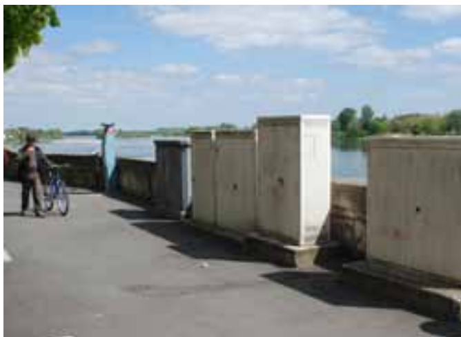
Coffrets techniques en bord de Loire ; Blois
