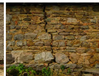
Fissure d'un mur composite de granit
