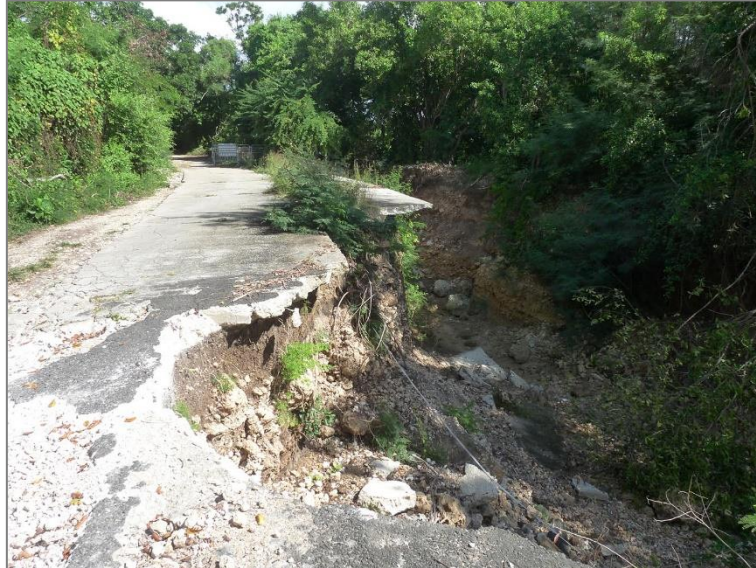
Figure 16 : Effondrement de route lors d'évènement pluvieux violent – secteur des Galets (Source : Tropisme)
