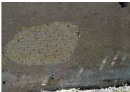
Les briques de terre crue apparaissent sous l'enduit qui s'est dégradé. Fleurance
