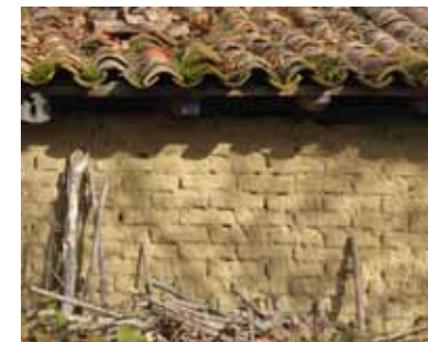
Petite annexe en briques crues. L'enduit de protection a disparu. Castet-Arrouy
