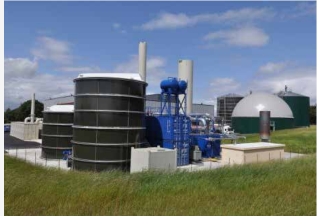
Usine de méthanisation Géotexia
