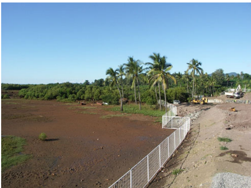
Travaux de raccordement de la RN2 au nouveau pont de la Kwalé
