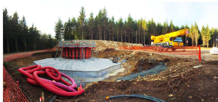
Parc du Sambrès - Montagne Noire, Aude : installation d'une éolienne dans une clairière réduite à son maximum et répondant aux exigences de l'Etat (DREAL/DDT)
